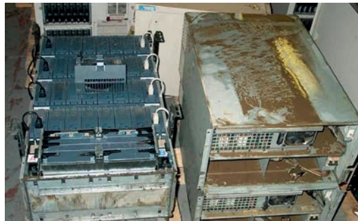
Po opadnutí vody zůstala na zařízení vrstvička jemného bláta.
