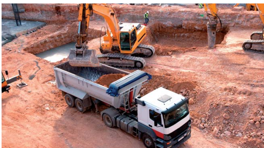
Podnikový odpad byl podobně jako v minulých letech z hlavní části (60 %) tvořen odpady stavebními a demoličními (11,9 mil. tun), přičemž převažovala zemina a kamení.
